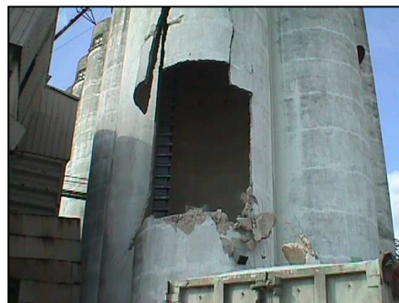
Rupture cellule à Vailly sur Aisne. (02)
